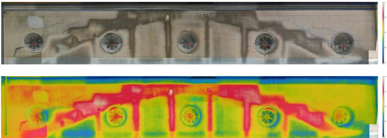
Figura: Esempio di ripresa termografica della struttura in cemento armato della Chiesa di Santa Maria Addolorata, Pratozanino, Cogoleto.
